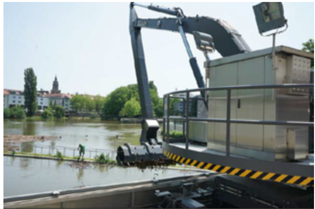
Rechenreinigung am Wasserkraftwerk Heilbronn
