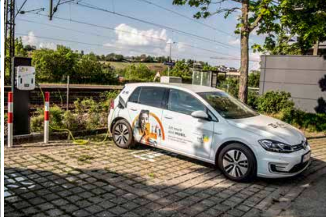
E-Fahrzeuge in Lauffen können seit diesem Jahr am P+R-Parkplatz in der Bahnhofstraße geladen werden.
