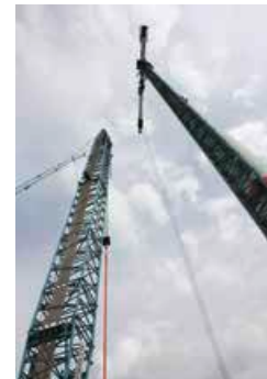
Hier befindet sich die Anlage in 160 Meter Höhe.
